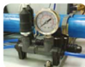
Gruppo di pressostati di minima, conduttivimetro per il controllo della massima e manometro.
